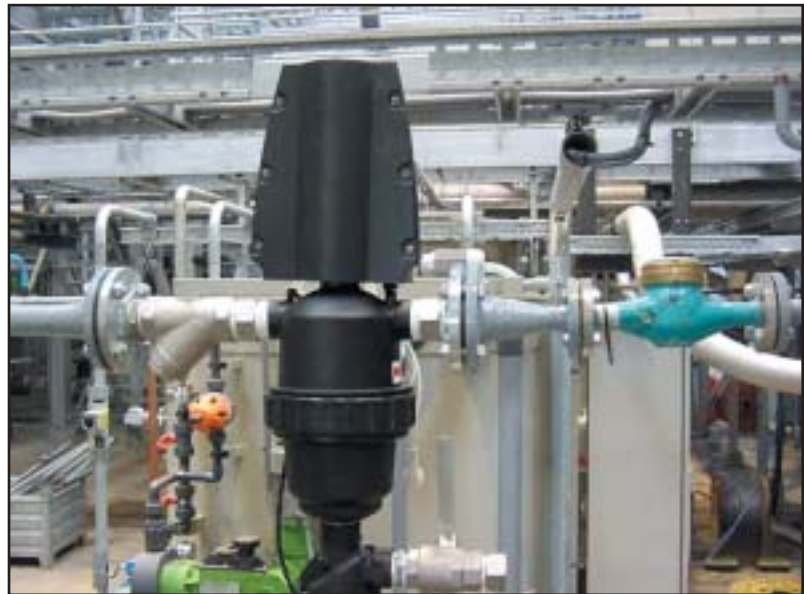
Подготовка сточных вод на биогазовой электростанции – ГОЛЛАНДИЯ
