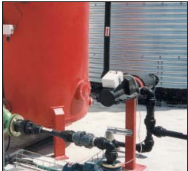
Предварительная фильтрация станции водоподготовки. Обратный цикл в теплице – ИЗРАИЛЬ
